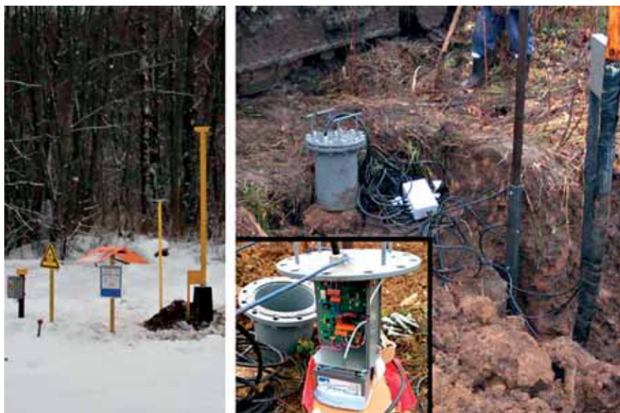
Фото 2. Система контроля переходов трубопроводов под автомобильными и железными дорогами СКП21 в подземном исполнении в защищенном аппаратном контейнере
