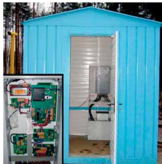
Фото 3. Система контроля переходов газопроводов под авто и железными дорогами СКП21 в наземном исполнении в монтажном шкафу (блок контейнер).
