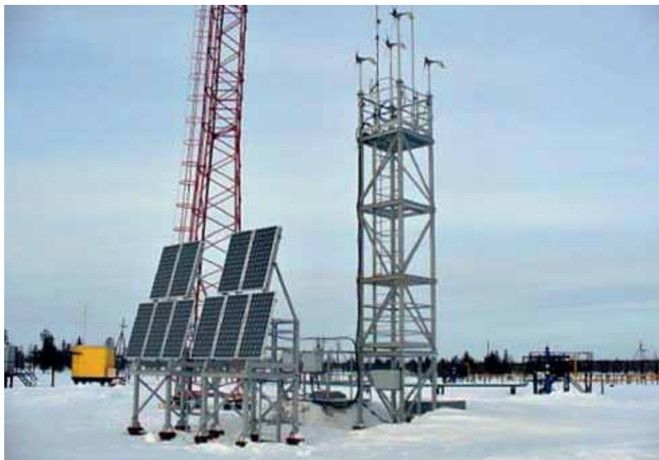
Рис. 1. Комплект энергоустановок НПО «Вымпел»
