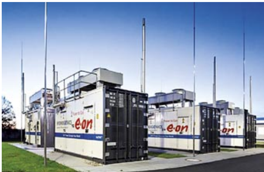
Фото 1. Электролизер в Халькенхагене
